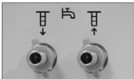
Fig. 64: Contratuercas en los racores de agua de refrigeración
